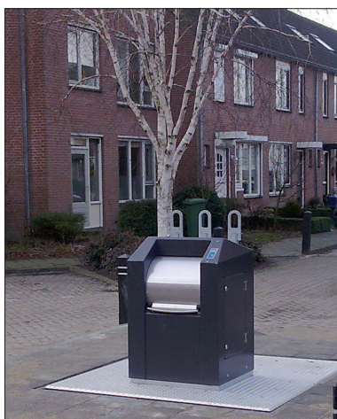
Einer von zwei Presscontainern in der Gemeinde Made - Drimmelen, NL
