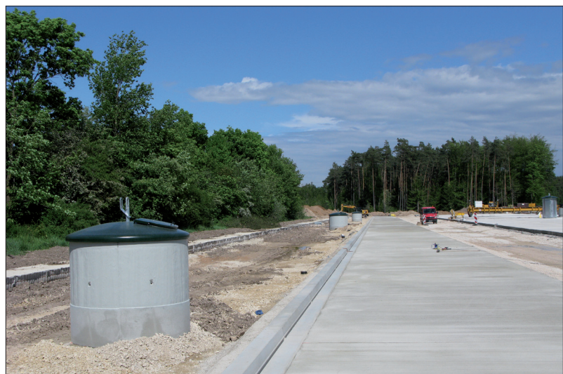
An der A6 in Deutschland. Der Architekt hat sich bewusst für Beton ohne Verkleidung entschieden.
